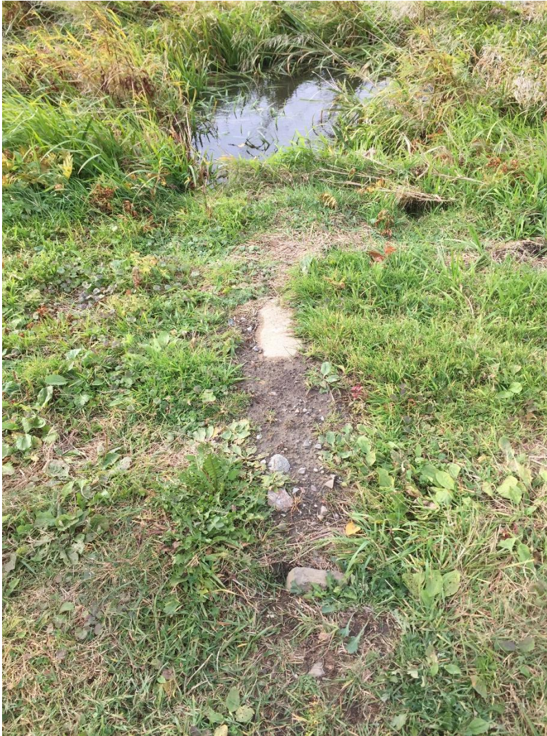
Photo 1 Ponceau endommagé à l'ouest du marais de Ste-Angèle.
