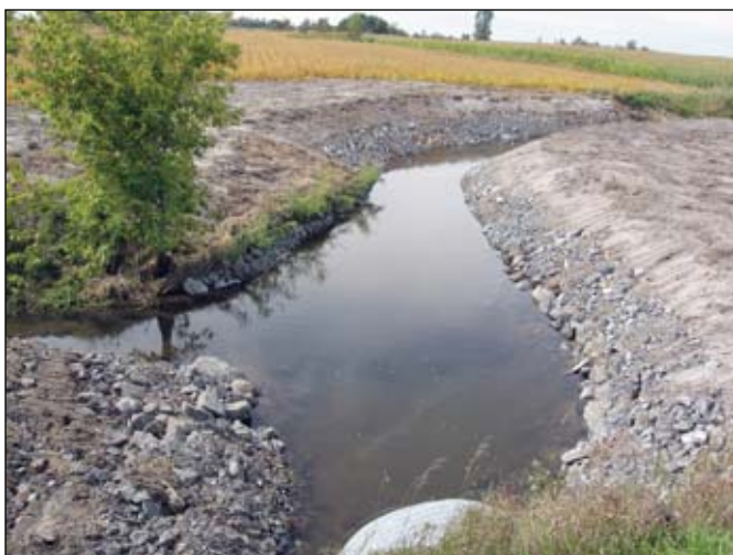
Photo 9 : Protection en aval d'un ponceau Source : Mikael Guillou, MAPAQ
