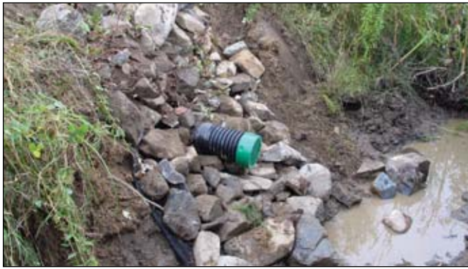
Photo 13 : Protection contre l'érosion à la sortie d'un drain Source : Mikael Guillou, MAPAQ
